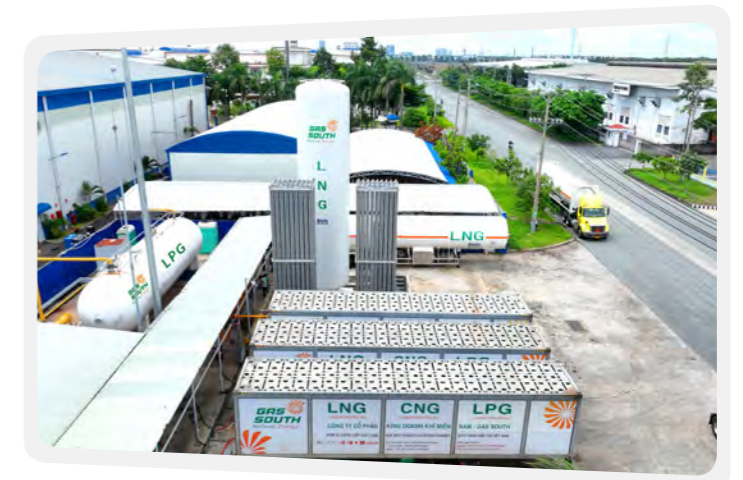
Trạm cung cấp tích hợp LPG, CNG và LNG
